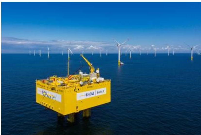
Nicht zu übersehen: das Umspannwerk von Baltic 2. Foto: EnBW
